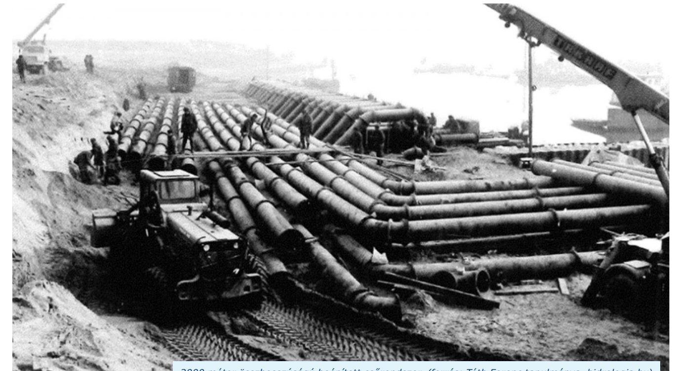
2000 méter összhosszúságú beépített csőrendszer. (forrás: Tóth Ferenc tanulmánya, hidrologia.hu)
